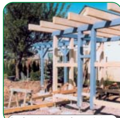
Das Gerätehaus ist eine Sonderanfertigung in den Farben des Hauses blau/grau.
